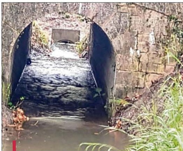
Les eaux de ruissellement ont du mal à s'écouler. Les buses sous la RN113 (photo prise au printemps) sont bouchées. / PHOTO DR
